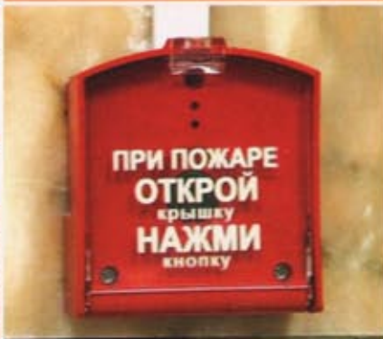
отсутствует или неисправна пожарная сигнализация, не хватает средств пожаротушения
